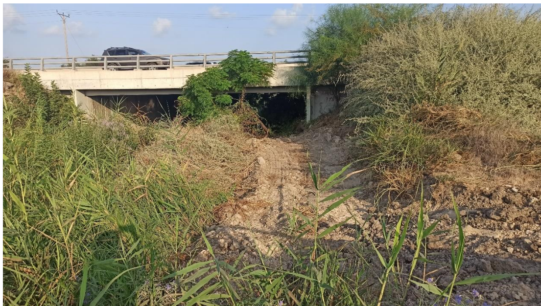
עבודות עפר בנחל עדה בסמוך לכביש 2 (גדה צפונית). במקום זה אותרו השנה ובשנים קודמות קינים, בדיוק בדרך העפר שנוצרה ונרמסה ע"י טרקטור שעבד במקום. פעולה זו גם הביא לעקירת צמחים רבים במקום.
